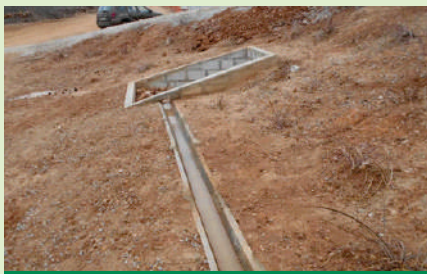
Exemplo de medida do PAC: Controle de Erosão e Assoreamento – implantação de rede de drenagem em talude, visando à coleta e escoamento das águas pluviais
