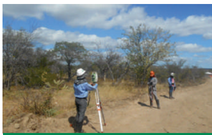
Exemplo de medida de controle de supressão – equipe de topografia demarcando o perímetro das áreas a serem suprimidas
